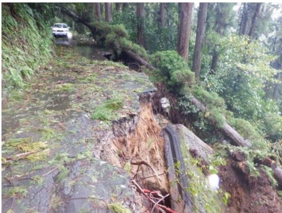
写真 台風14号により崩壊した道路
