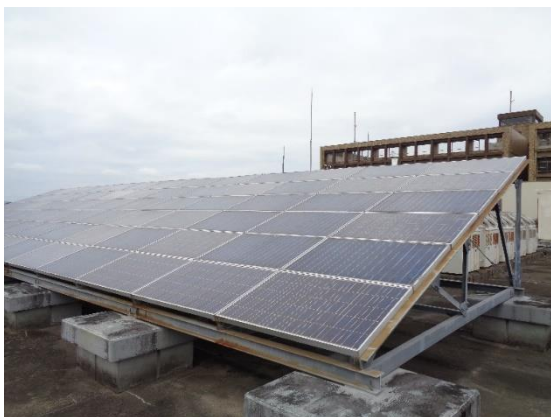
写真 太陽光発電（都城市役所）
