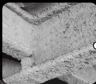
吹付けアスベスト
