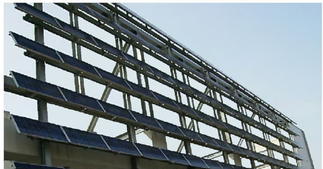
▲クリーンエネルギー実用例 （都城合同庁舎の太陽光発電システム）
