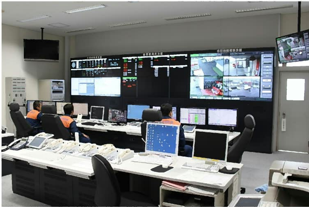
高機能消防指令センター
