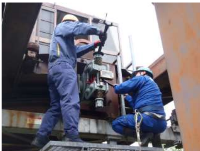
非常制動装置点検整備状況
