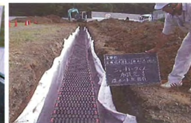
浸透管とその周囲の充填材から構成される構造物。ポンプ送水すると孔から散
