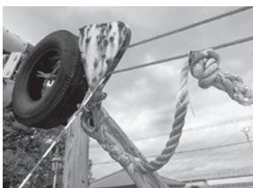
滑車部分とロープの劣化
