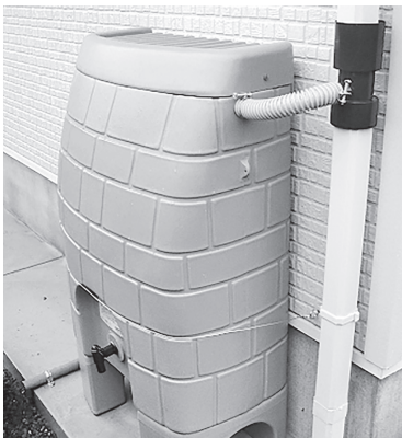
雨どいを利用した雨水貯水槽
