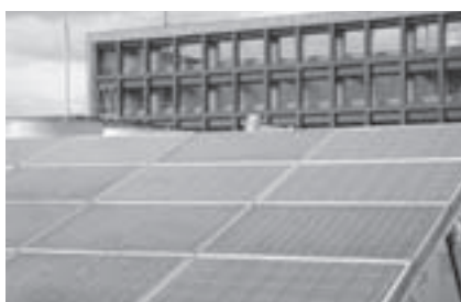
市役所南別館の屋上に設置した太陽光発電
