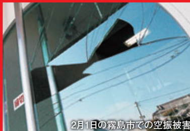
2月1日の霧島市での空振被害
