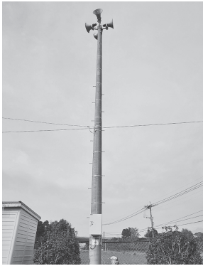
屋外放送設備 (丸谷自治公民館)
