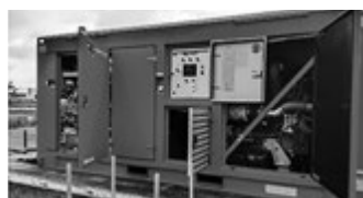
排水ユニット（制御装置）
