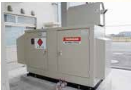
自家発電設備
