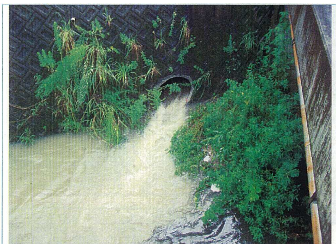
【右写真】大雨の降り始めに、雨水吐き室の越流堰を超えて、年見川に流れ出る未処理放流水。 (平成 16 年 改善対策前の写真)
