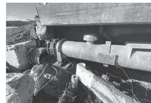
能登半島地震で破損した珠洲市の送水管（日本水道協会提供）。水道施設の被災により、広範囲で断水が発生したと報告されている。
