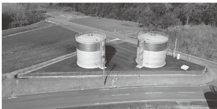
老朽化した施設を統廃合し、新たに完成した山田配水池。安全で安定した水道供給を支えている。
