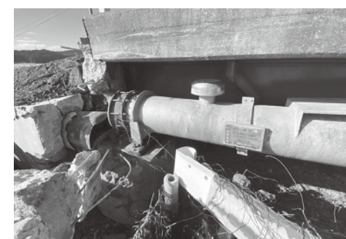
能登半島地震で破損した珠洲市の送水管（日本水道協会提供）。水道施設の被災により、広範囲で断水が発生したと報告されている。
