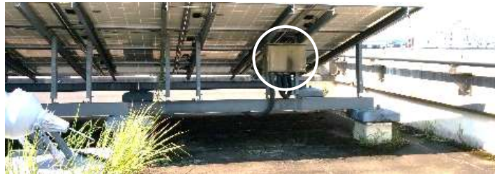
○電源④、ブレーカー③
