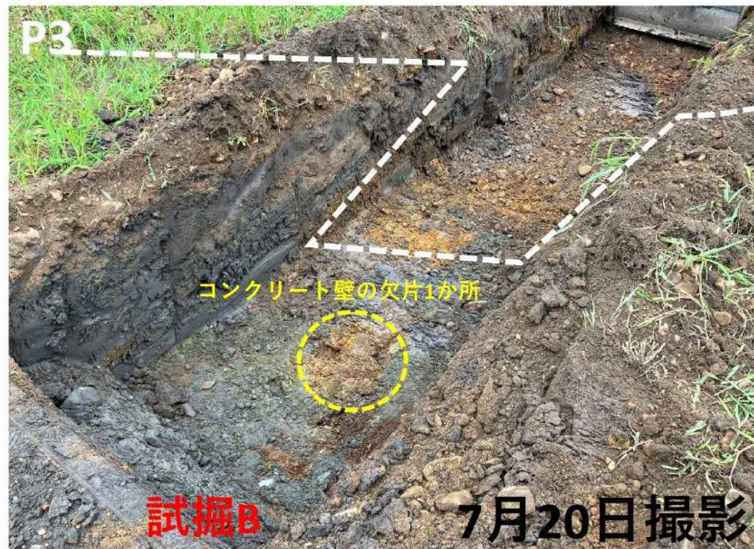
右側側面部のコンクリートについては無くなっており、コンクリートの欠片を1か所確認できたのみである。
