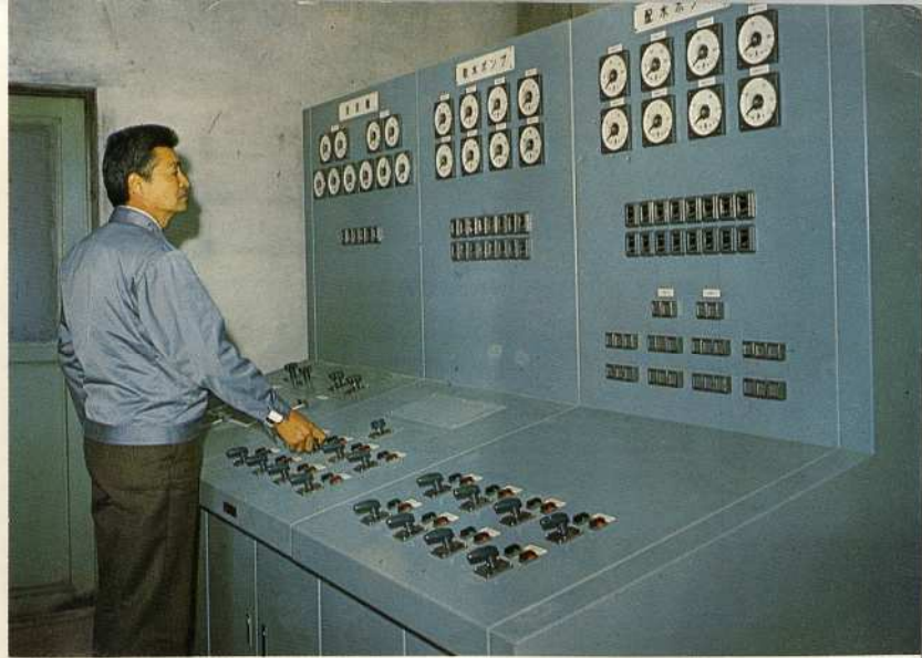
▲ 高蒲原浄水場配水操作盤
