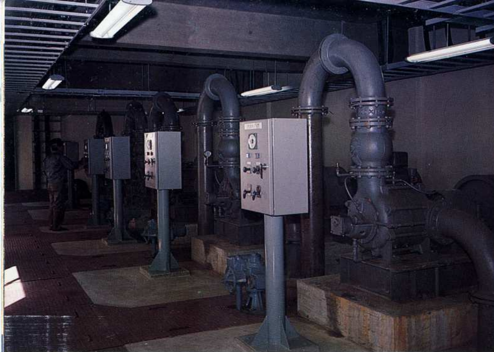
▲ 川東浄水場送水ポンプ (132kW×5台)
