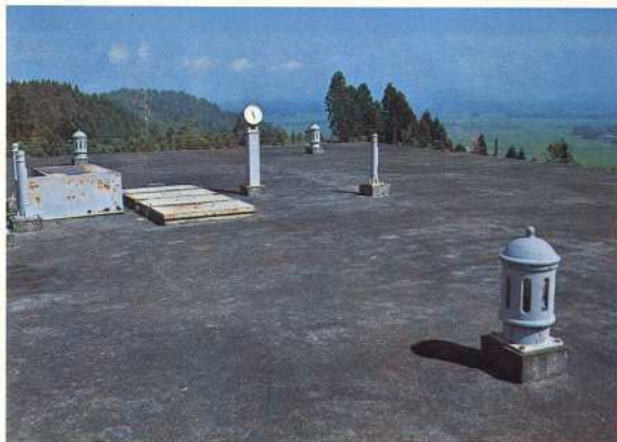
▲ 志和池配水池 (容量491m 3 )
