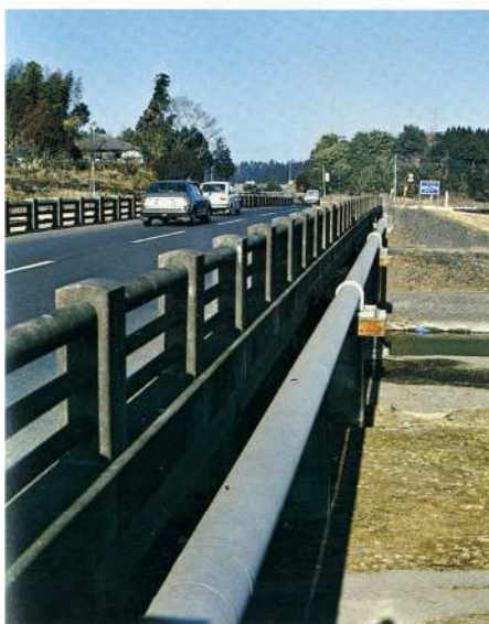
▲ 平田橋に添架された450mm配水管
