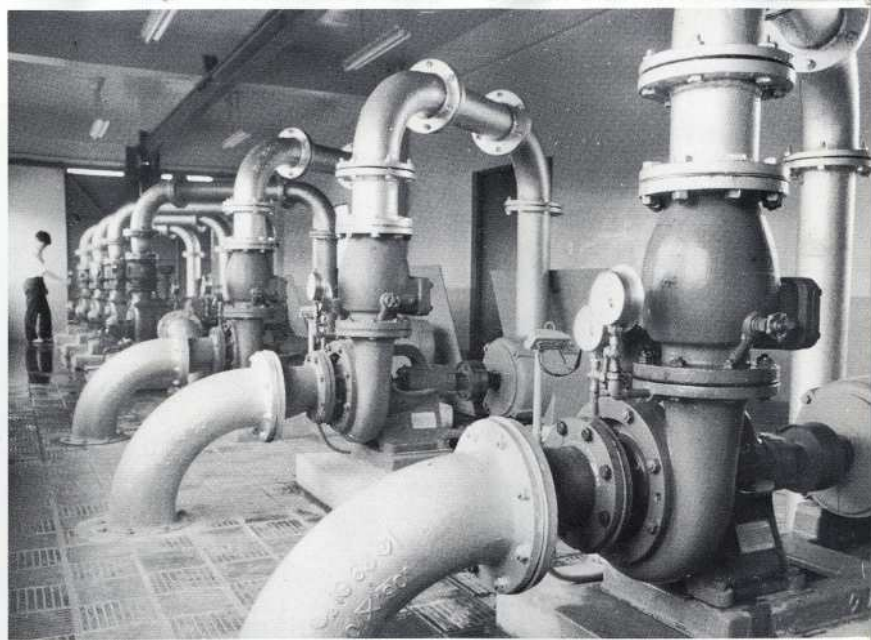
▲ 川東配水ポンプ、第2次拡張により使用を停止
