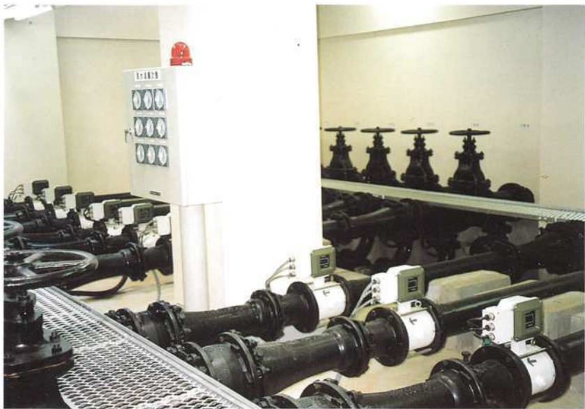
着水井取水流量計室▶
