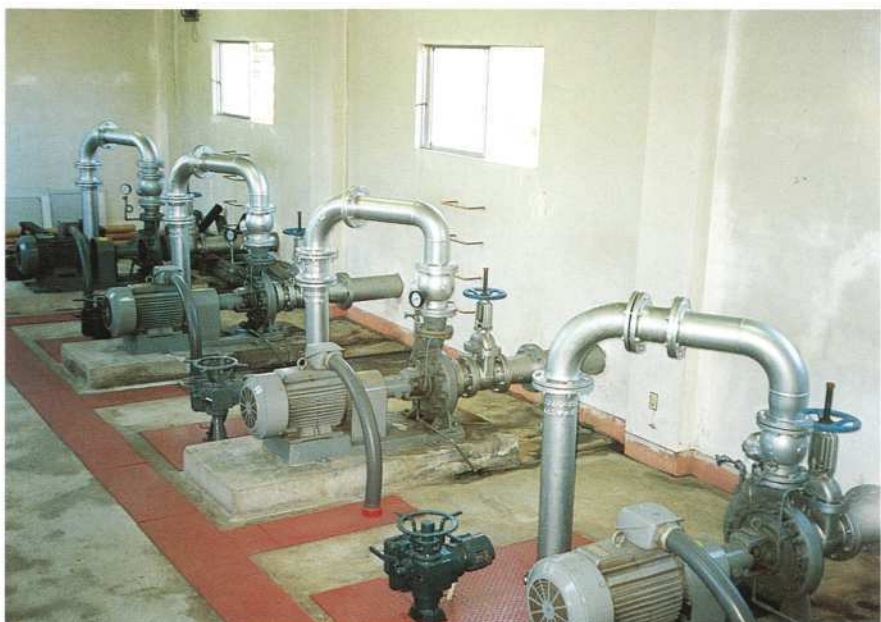
配水ポンプ室▶ 37kW×4台
