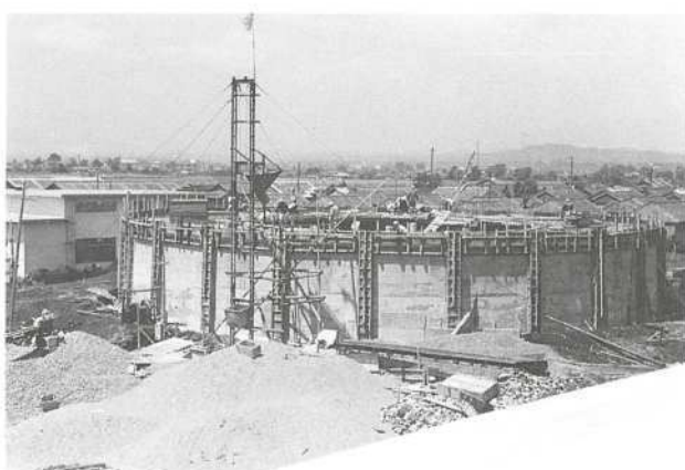
▲菖蒲原配水池（容量2,250㎡）
