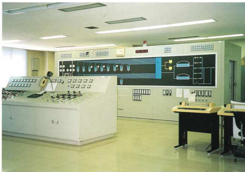
送配水コントロール室▶
