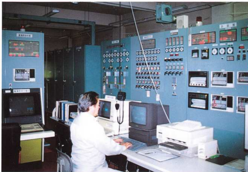
集中監視制御室▶
