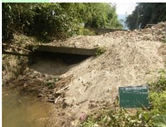
土砂が堆積した水路
